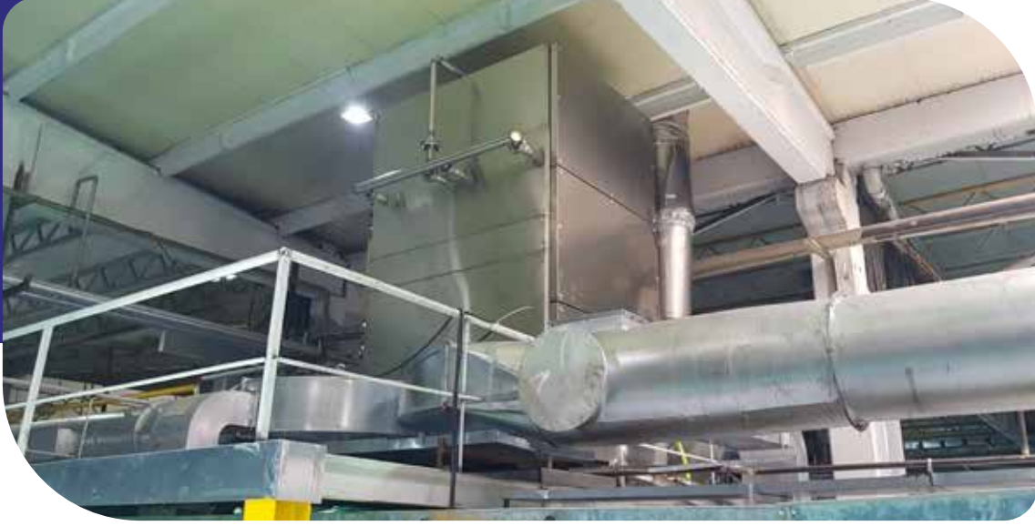
Şekil 8. Ram Bacası Atık Gazları Temizleme ve Geri Kazanım Sistemi - Baca Giriş Çıkış Yapısı Figure 8. Ram Chimney Waste Gas Cleaning and Recovery System - Chimney Inlet and Outlet Structure
