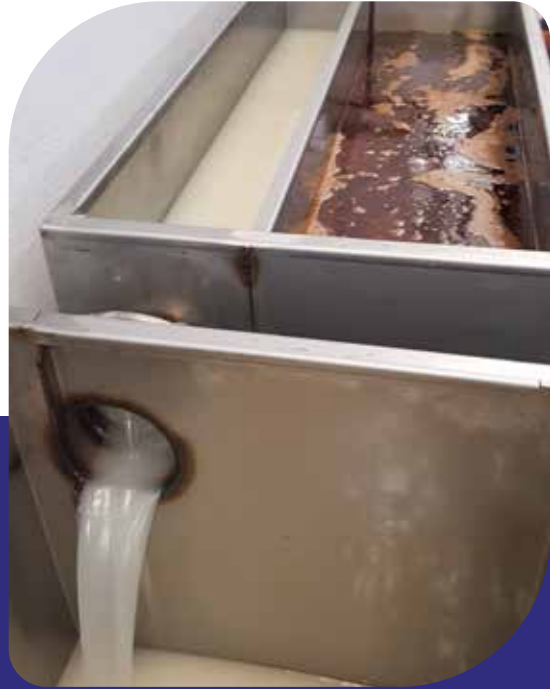
Şekil 3. Ram Bacası Atık Gazları Temizleme ve Enerji Geri Kazanım Sistemi Yağ/Su Ayırma Tankı
