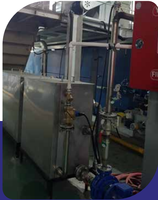
Şekil 8. Ram Bacası Atık Gazları Temizleme ve Geri Kazanım Sistemi - Baca Giriş Çıkış Yapısı Figure 8. Ram Chimney Waste Gas Cleaning and Recovery System - Chimney Inlet and Outlet Structure
