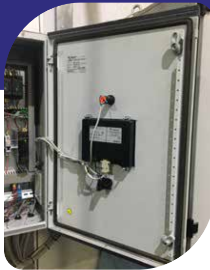
Şekil 6. Ram Bacası Atık Gazları Temizleme ve Enerji Geri Kazanım Sistemi Elektrik Kumanda Panosu
